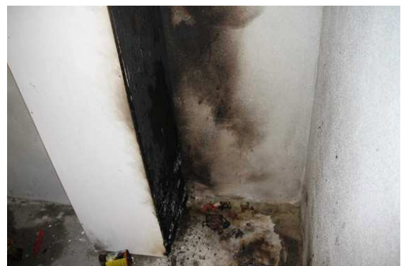
Verbrande muur in de onderdoorgang naast de werkruimte (foto: Martin van Rijn).
